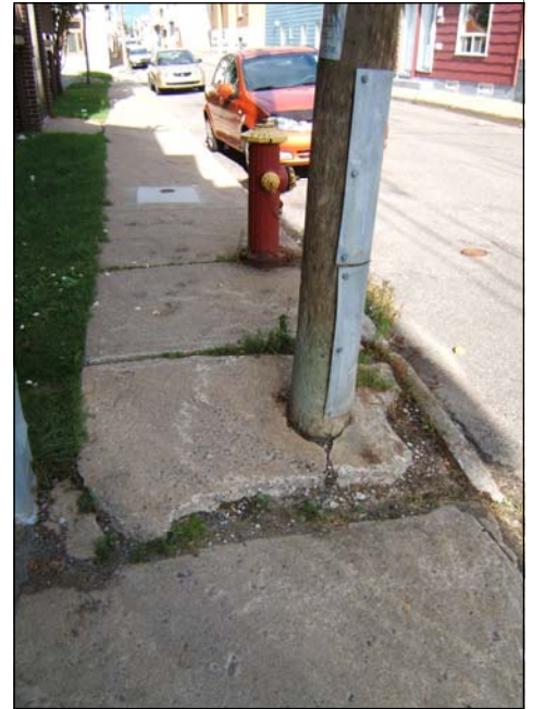
Mauvais état d'un trottoir déjà trop encombré. Photo: Marie-Joëlle L.B.
